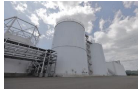
2023年5月 メタン発酵設備 稼働
