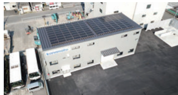
屋上に太陽光発電設備を設置した京都営業所
