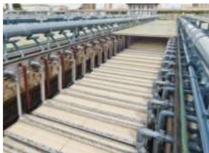
水処理プラント
