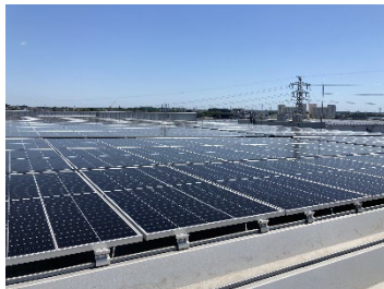
太陽光発電を海老名工場に建設 (左写真5月稼働)
