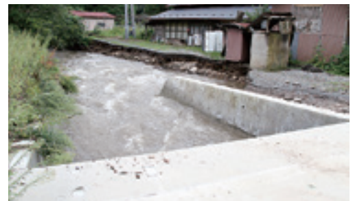
増水によって道路が崩落（沢内地区）
