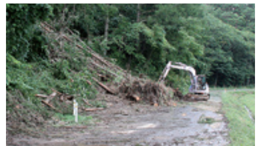
土砂崩れのため通行止めになった村道高屋敷山形線
