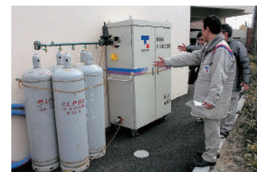
優先支援需要家の病院に「移動式ガス発生設備」を設置
