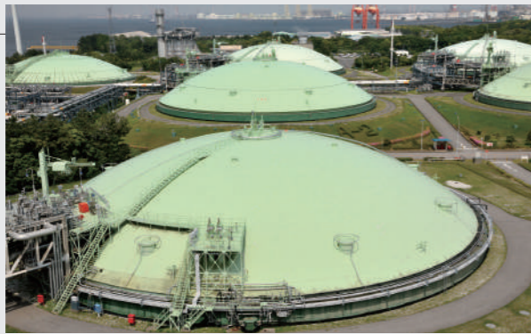
LNGタンク外観
