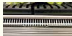
清潔に保たれた冷気の吹き出し口
