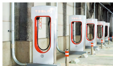
A PIT AUTOBACS KYOTO SHIJOIに設置しているテスラ社の急速充電設備「スーパーチャージャー」
