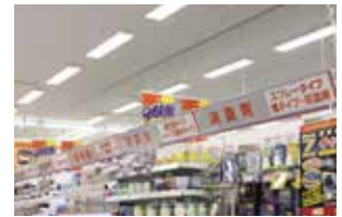
LED照明 (オートバックス大和郡山)
