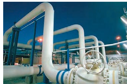
Εικόνα 39.2: Εργοστάσιο Δ.Ε.Π.Α. (ΔΗΜΟΣΙΑ ΕΠΙΧΕΙΡΗΣΗ ΑΕΡΙΟΥ)
