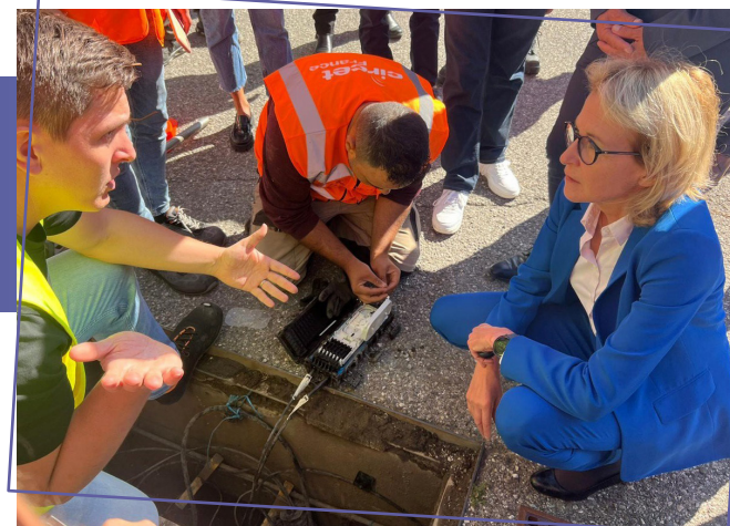
↑ Visite terrain autour d'un point de branchement optique situé en chambre.
