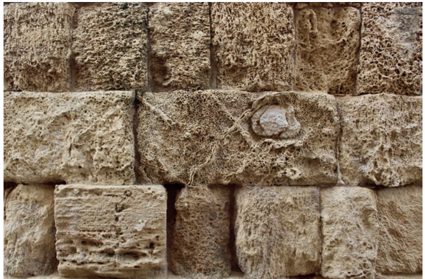
Fig. 2. Cesarea Marittima, Teatro romano. Particolare della tessitura muraria del muro della parodos occidentale. Si notano lacerti di stucco e il forte deterioramento della pietra causato dall'esposizione agli agenti atmosferici (foto dell'A., febbraio 2019).
