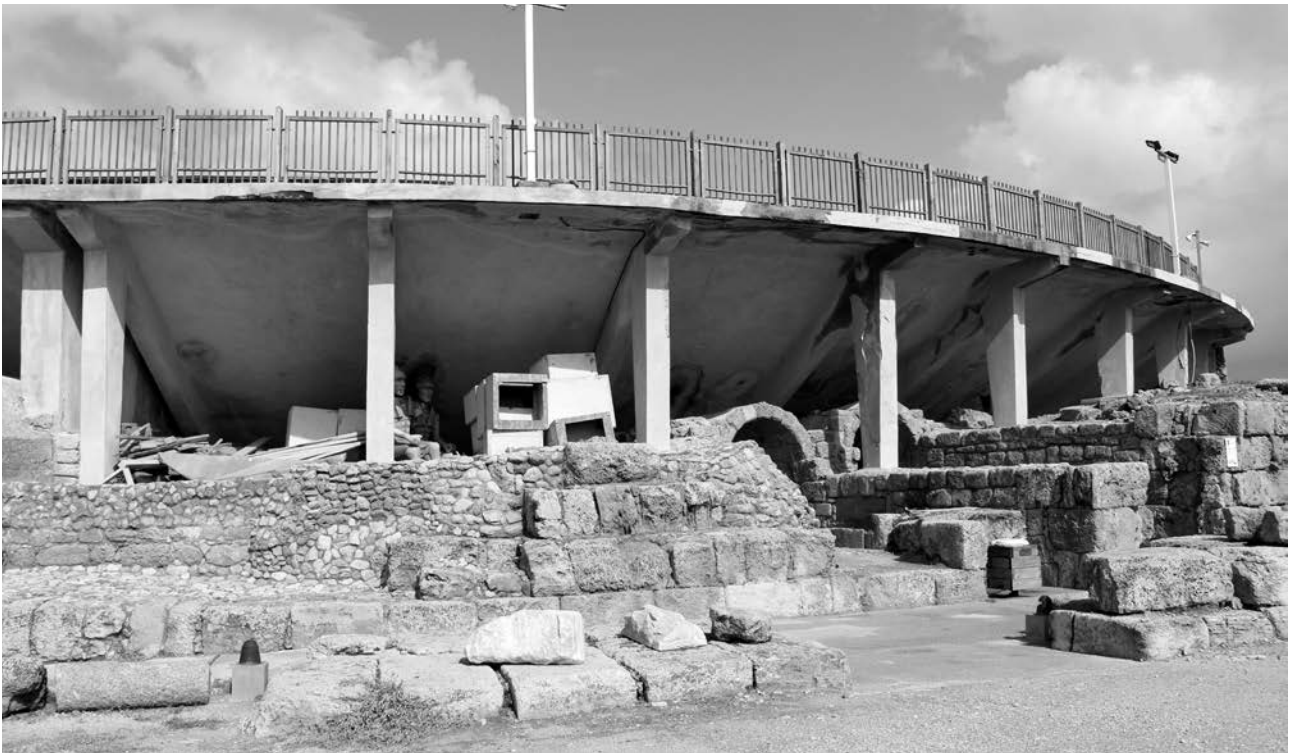
Fig. 14. Cesarea Marittima, Teatro romano. Vista del prospetto esterno nord-ovest, con il restauro realizzato negli anni Sessanta e la costruzione dei piloni portanti sotto la cavea , in fase di degrado (foto dell'A., febbraio 2019).
