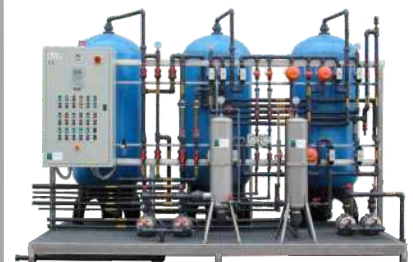
Impianto resine selettive
