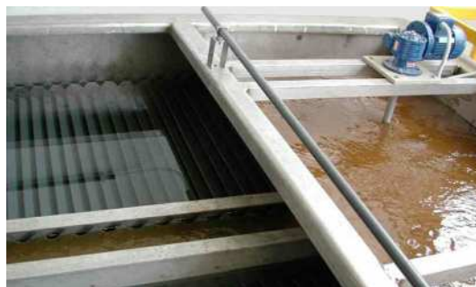
Vasca di flocculazione e decantatore lamellare
