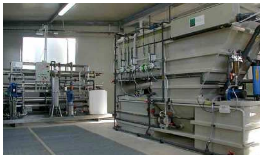
Impianto di depurazione con processo a solfuro - 3 mc/h
