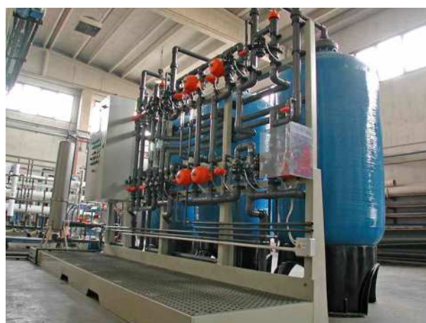
Tutti gli impianti Tec.A. sono premontati e collaudati nello stabilimento di Beinasco (TO) prima della spedizione
