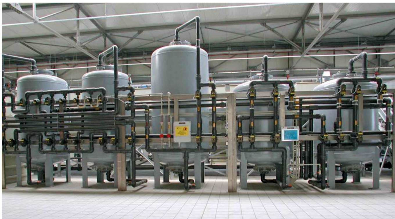
Impianto di Polishing Finale - 20 mc/h
