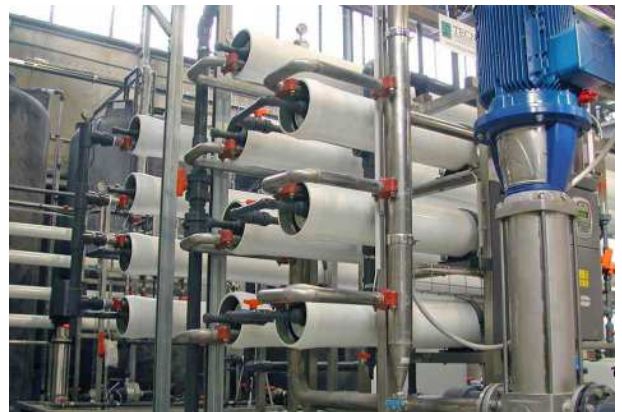
Osmosi Inversa riciclo scarichi - 15 mc/h
