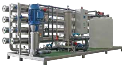
Impianto di Osmosi Inversa
