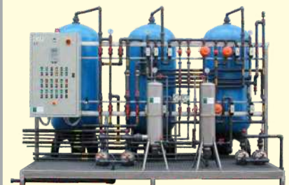
Impianto resine selettive
