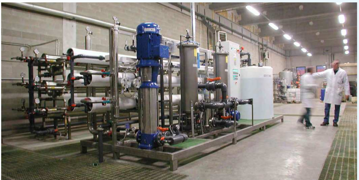
Impianto di osmosi inversa – 30 mc/h
