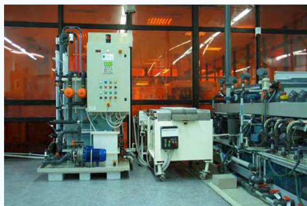
Impianto ultrafiltrazione sviluppo solder – 100 lt/h
