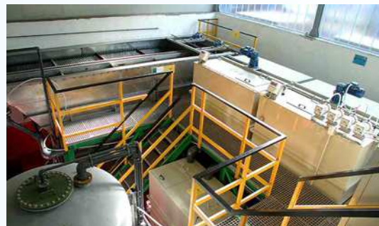
Impianto chimico-fisico - 30 mc/h
