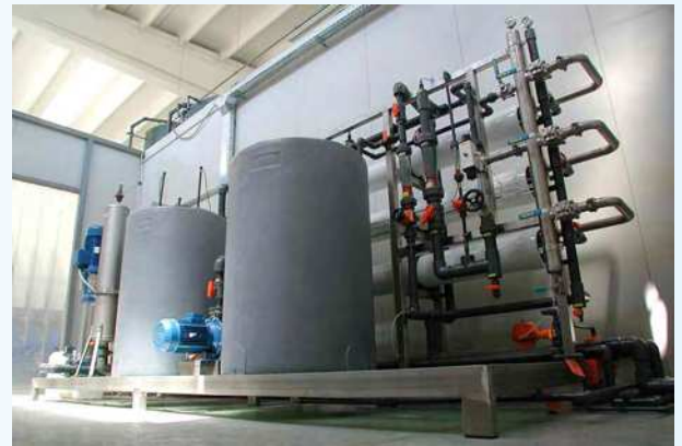
Impianto di osmosi inversa riciclo scarichi 15 membrane - 10 mc/h
