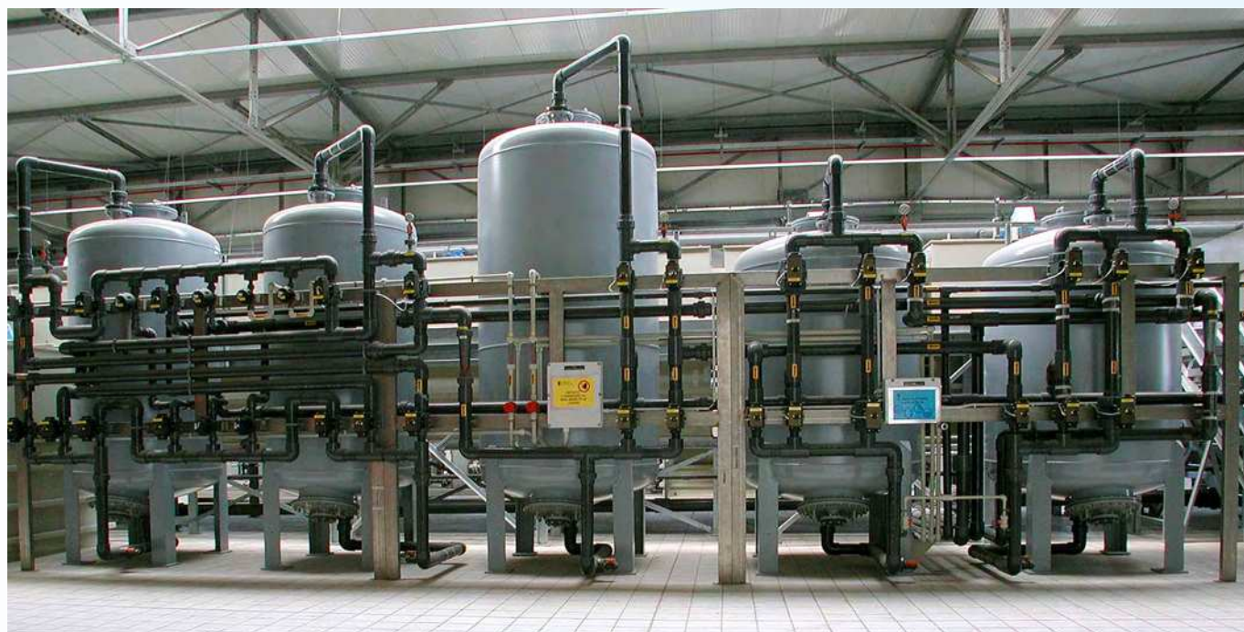
Impianto di Polishing Finale - 20 mc/h
