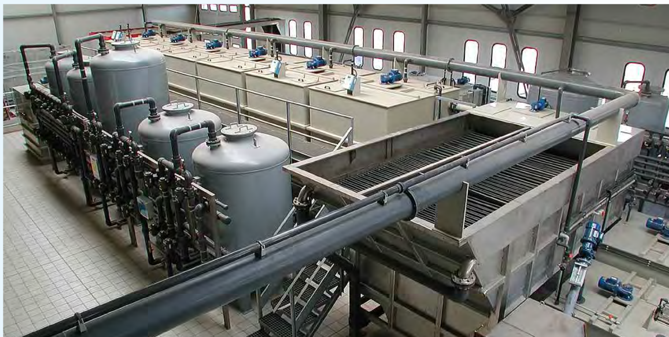
Impianto di depurazione con processi Fenton e solfuro - 20 mc/h
