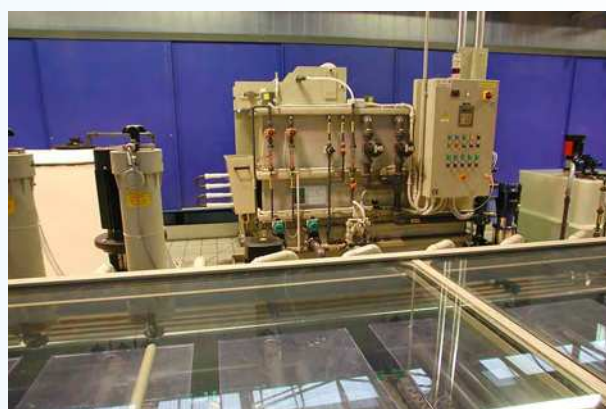
Impianto ultrafiltrazione strippaggio dry/film – 200 lt/h
