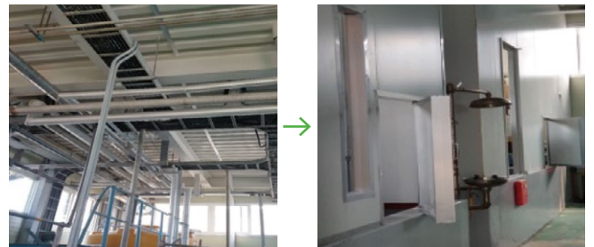
▶ 천안 사업장 폐수처리장 염산 저장탱크 구획
