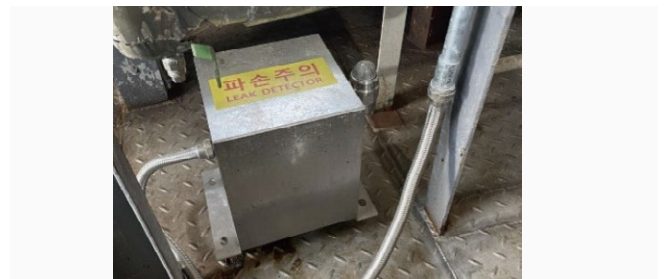
▶ 온면 계면제조실 누액감지기 설치
